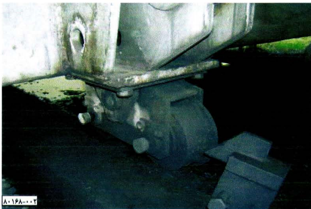
شکل ۱-۲: ترانسفورماتور با حرکت و تغییر وضعیت مکانی جزئی به نسبت وضعیت قبل از زلزله (وجود و نصب چنین تجهیزاتی از تخریبهای اساسی جلوگیری می کند. در صورت ثابت بودن این واحد امکان تخریبهای زیادی در این ترانسفورماتور مورد انتظار بود. ۳ )
