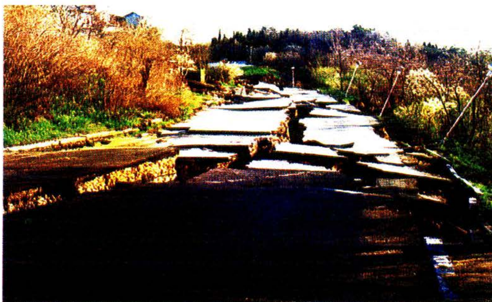
شکل ۱-۳: ترکها و شکافهای عمیق در اثر زلزله که می توانند تخریب جدی در ۸۰۱۶۸-۰۰۳ تاسیسات زیرزمینی نظیر لوله های آبرسانی را باعث شوند*.
